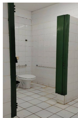
Imagem 19 – WC acessível sem porta no segundo piso da Escola B.
