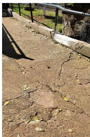
Imagem 44 – Rampa de acesso ao terreno com rachaduras na Escola D.
