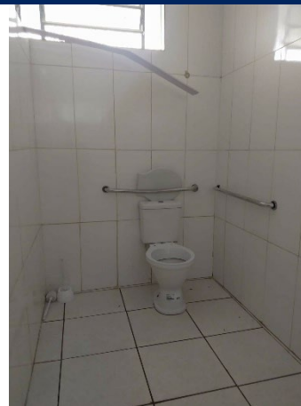
Imagem 8 – Falta a terceira barra de apoio no vaso sanitário da Escola A.
