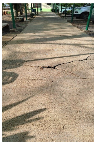
Imagem 24 – Rachadura no piso com elevação da Escola C.
