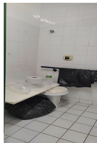
Imagem 17 – WC feminino acessível no piso térreo da Escola B.
