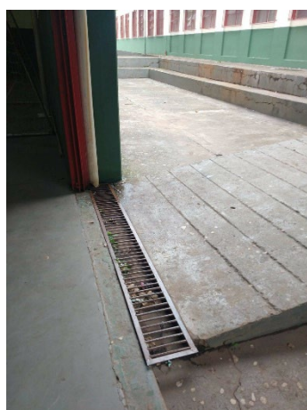
Imagem 9 – Acesso ao ginásio da Escola A, grelha com espaçamento maior de 15 mm e sentido correlato à entrada.
