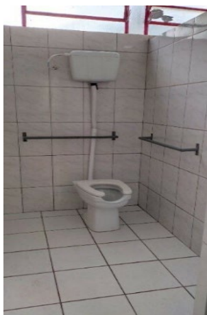
Imagem 35 – WC acessível feminino da Escola C: falta uma barra. Fonte: Fotografado pelo primeiro autor (2022).
