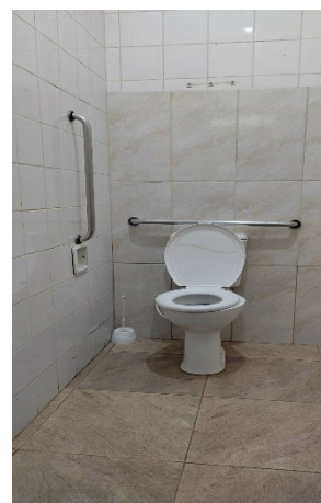
Imagem 54 – Falta de barra horizontal no WC acessível masculino na Escola D. Fonte: Fotografado pelo primeiro autor (2022).
