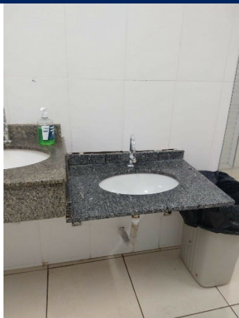
Imagem 7 – Pia na parte interna do sanitário da Escola A.
