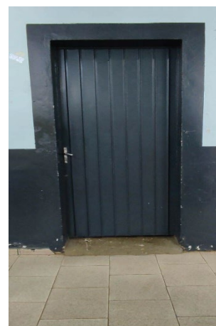
Imagem 49 – Porta na sala de vídeo Escola D, com rampa inadequada. Fonte: Fotografado pelo primeiro autor (2022).
