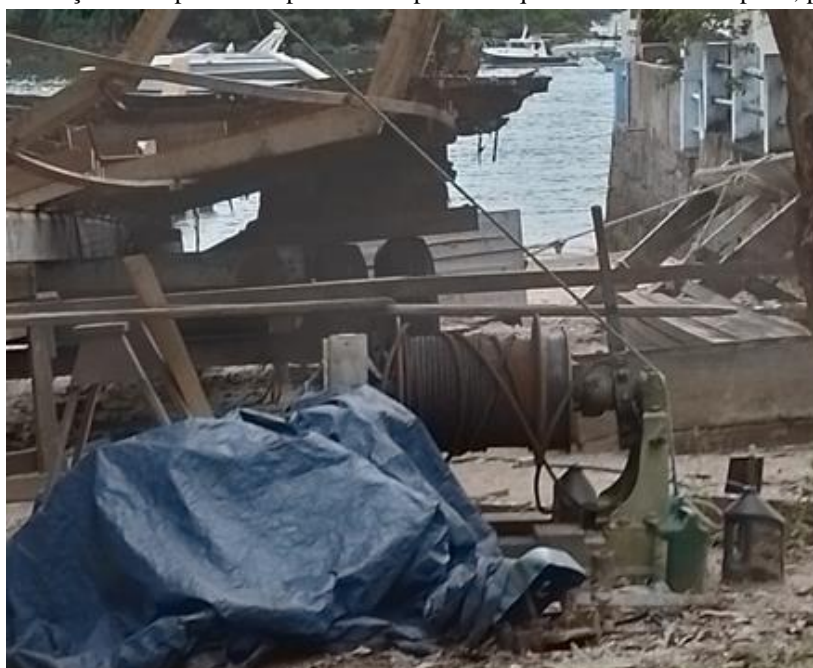
Figura 6: Embarcação em reparo acompanhada de produtos químicos na areia da praia, próximo ao mar
